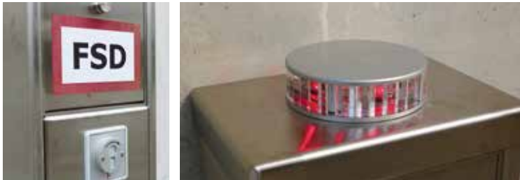
Abbildungen 2 a) + b): Erstanlaufstelle für die Feuerwehr mit FSD und FSE, häufig gekennzeichnet durch eine rote Blitzleuchte (Quelle: SFSG)
