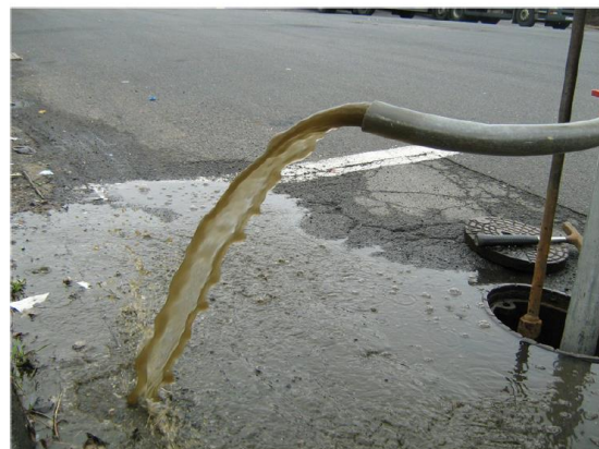
Stagnation im Hydrantenanschluss
