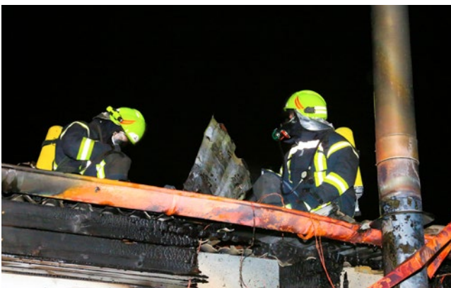
In Hasenmoor bekämpfte die Feuerwehr einen Dachstuhlbrand.
