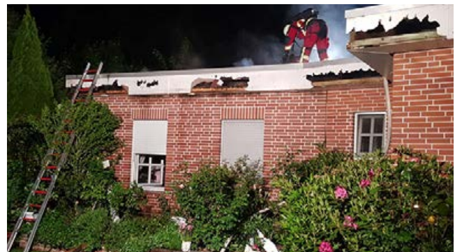
Mittels Rettungssäge verschaffte sich die FF Bad Segeberg Zugang in das Flachdach.
