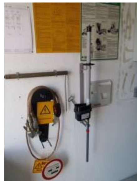
Bild 5-42: Erd- und Kurzschluss-Kit für den Transformator
