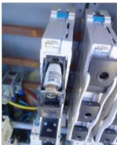
Bild 5-39: Trenner mit Sicherung
