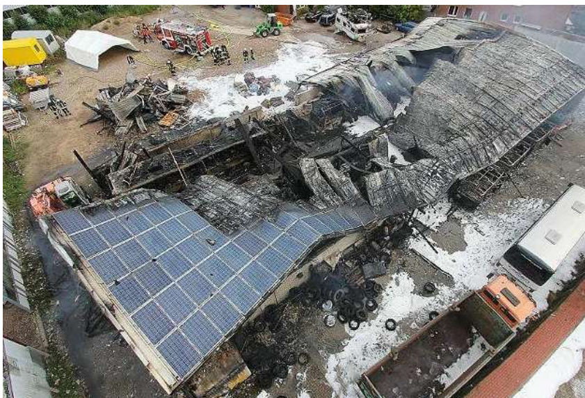
Bild 3-9: Nach dem Brand einer Werkstatt mit Lager und Fahrzeughalle (Bild: Feuerwehr Norderney)
