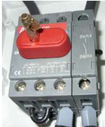
Bild 3-26: Geprüfter DC Hauptschalter mit Kontakt -Wippe
