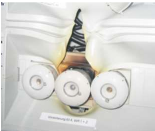
Bild 3-30: Heiß gewordener Sicherungseinsatz (Foto: H. Godard, Energossa)
