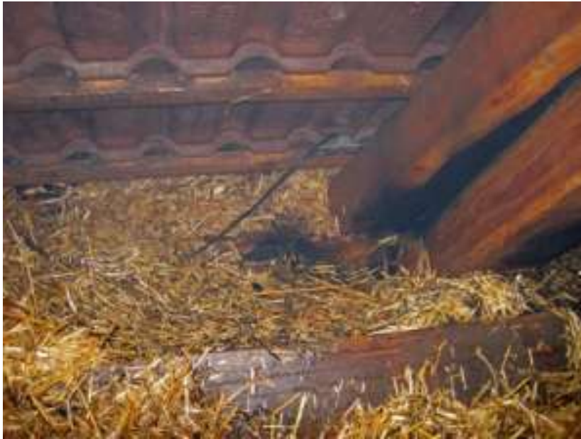
Bild 3-33: Glimpflich verlaufener Brandfall (Foto: Feuerwehr Ellwangen)
