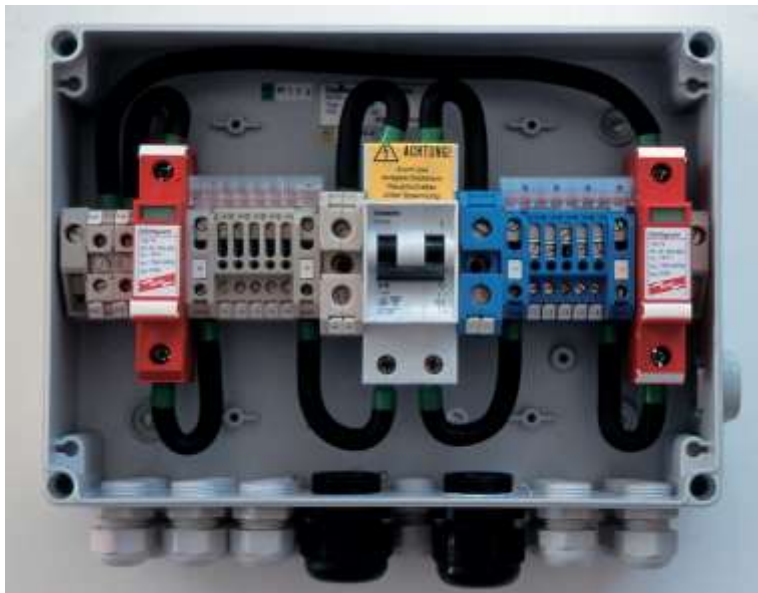
Bild 3-51: Generatoranschlusskasten [Quelle: DGS-Berlin]
