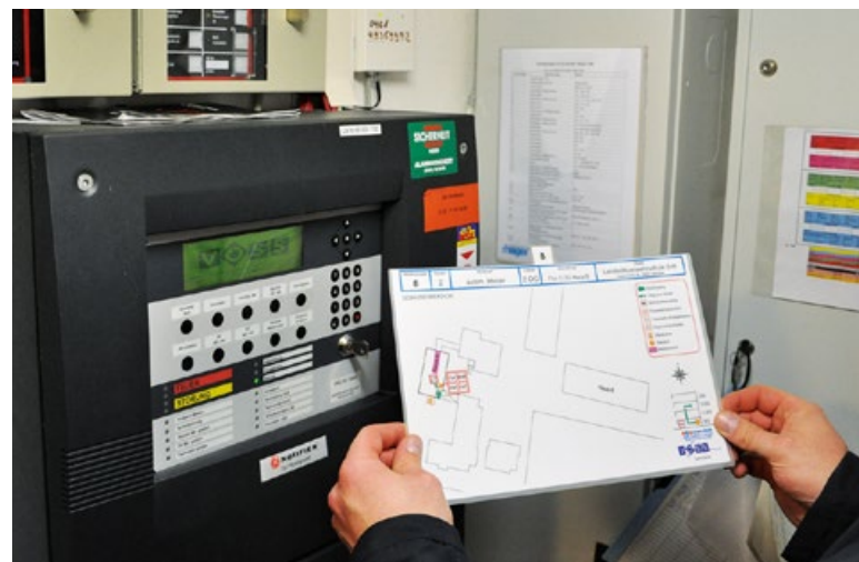
Einsatzvorplanung mit Objektkunde ist auch Aufgabe der Feuerwehr.
